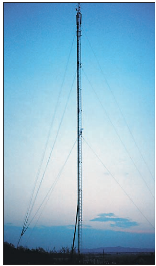
Antenski stolp v Novi vasi. Foto: FI
