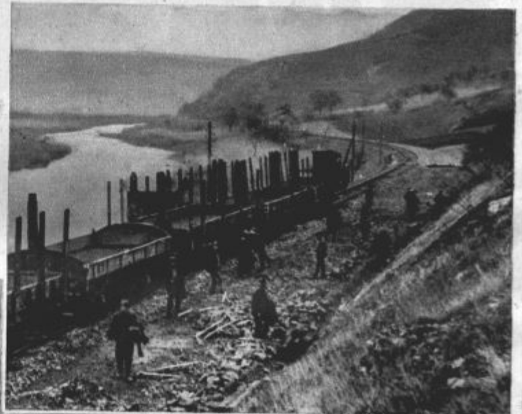
Deutsche Bahnerstörungen im Nahetal im Interesse der „Sicherheit Frankreichs“. Auf Grund der erst kürzlich veröffentlichten geheimen Abmachungen, die zwischen Deutschland und Frankreich im Haag getroffen wurden, muß Deutschland verschiedene zweigleisige Bahnstrecken, deren Hauptbedeutung angeblich nicht auf wirtschaftlichem, sondern auf strategischem Gebiete liegen soll, in den eingleisigen Zustand überführen. Das bedeutet Verkehrserschädigung der Wirtschaft und sinnlose Wertzerstörung. — Aufräumungsarbeiten an dem abgebrochenen zweiten Gleis der Strecke Bad Rinsler am Stein — Obernheim. S. B. D.
