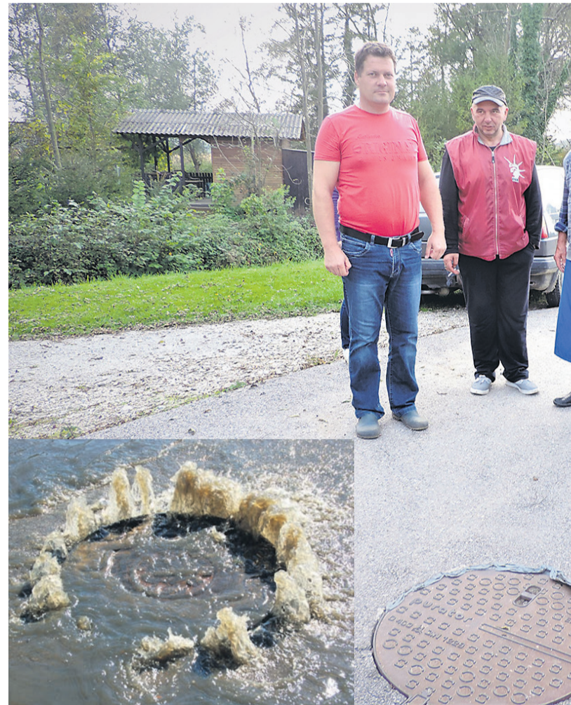
Domačini opozarjajo na nevzdržne razmere: na smrad in iztok fekalij iz kanalizacijskega jaška.
