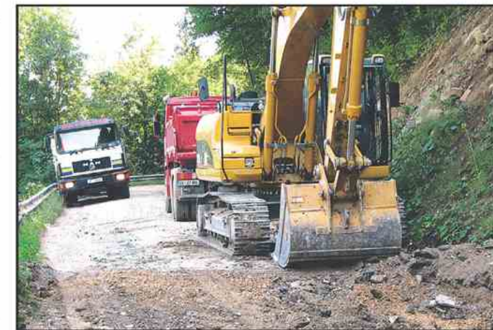
Dela pri rekonstrukciji ceste v Skorno naj bi predvidoma trajala mesec dni.
