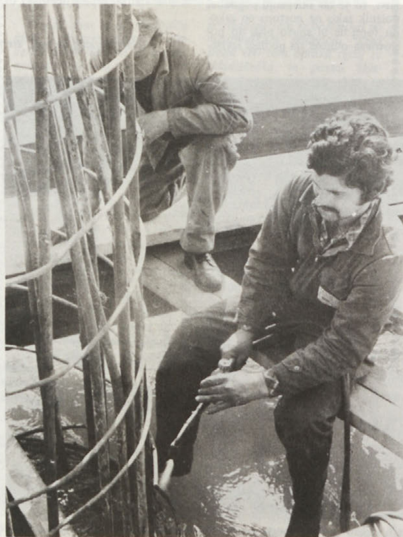
Varilca varita armaturo na prvem nizu treh stebrov tik nad vodno gladino Krke na gradbišču mostu v Novem mestu
