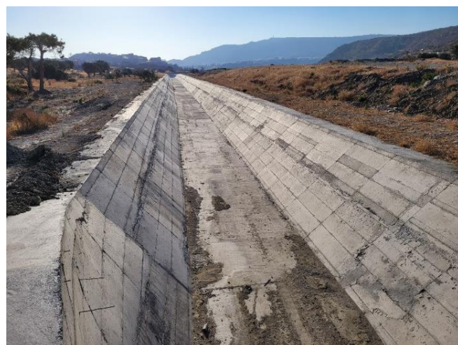
Odvodni kanal proti morju. Na mestu, kjer kanal poteka pod glavno cesto, je majhen mostiček, ki bi ob res veliki vodi zagotovil temeljito poplavljenost zahodnega dela Pigadie.
