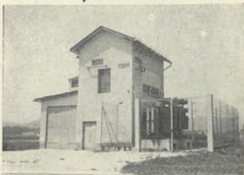
Transformatorska postaja za transformacijo napetosti 35.000 voltov na 10.000 voltov. V stavbi so stikalne naprave, na desni dva transformatorja
