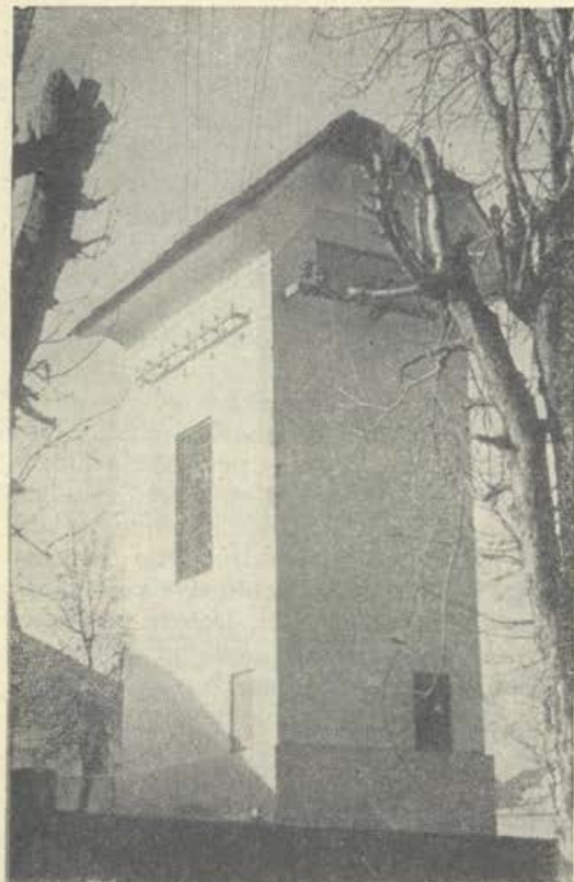
Napajalna transformatorska postaja, ki transformira električno energijo od napetosti 10.000 voltov na 380 voltov za splošno uporabo; podobnih postaj je v Sloveniji okoli tisoč
