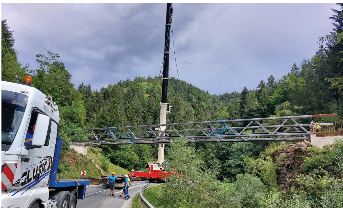
Slika 1. Montaža jeklene konstrukcije nadvoza N1 čez glavno cesto in Pako s pomočjo avtodvigala, avgust 2022.
