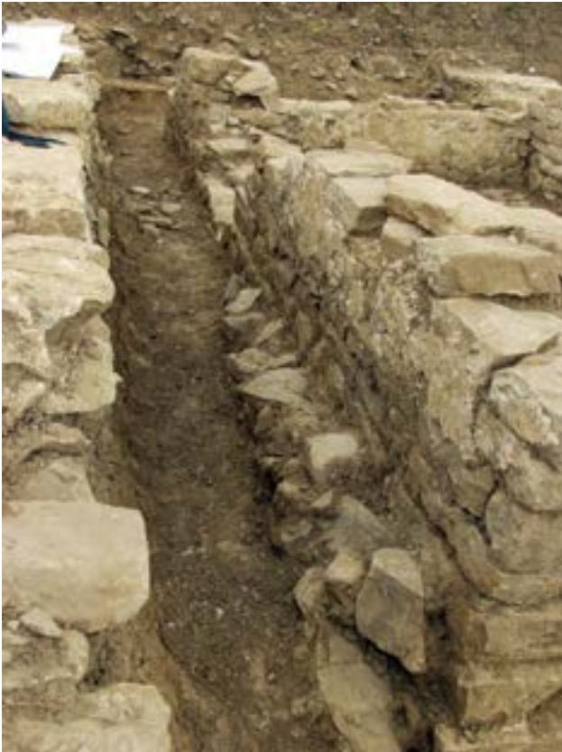
69 Pogled na zunanjo steno zidu SE 399 s temeljem, ki nakazuje vrh kolvija ob gradnji.
