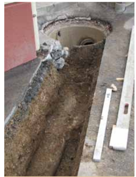
Problematični jašek in meteorni cevovod
