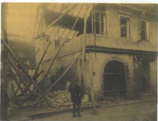
Močno razpokane objekte so zasilno podprli.
