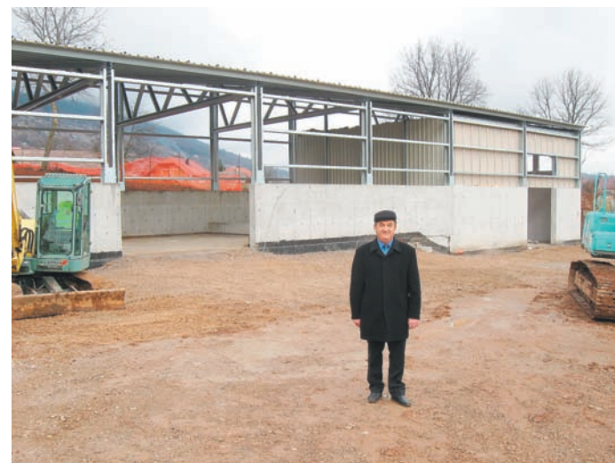
Direktor Zarje Koviš Ivan Hribar pred rastočim objektom sodobne kotlovnice na lesno bio maso v Semiču.
