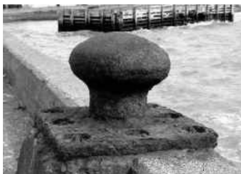
Slika 8: Prikaz enakomerne korozije (4)
