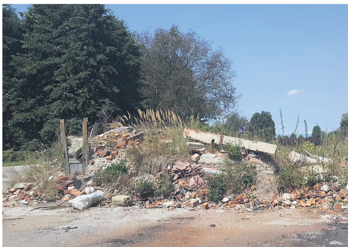
Rušitev objekta na severni strani ceste je inšpekcijska služba naložila že leta 2014, a kup ruševin je tam še danes. Foto: DK
