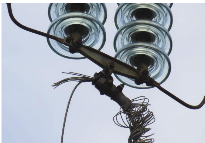
Slika 15 • Poškodovane so bile tudi vrvi in obešalna oprema daljnovodov
