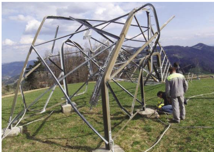
Slika 12 • Temelji so ostali v veliki večini nepoškodovani
