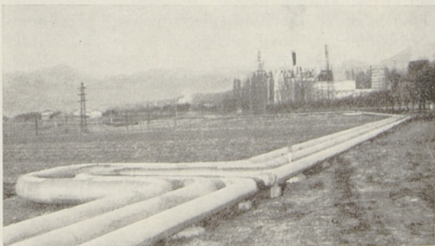
Že več let ogrevajo stavbe v Velenju s paro, ki prihaja po velikih ceveh iz stare termoelektrarne. V prihodnjih letih bodo te cevi in paro zamenjali podzemeljski plinovodi, ki bodo dovajali plin iz Velenja Jesenicam, Ljubljani, Mariboru in drugam
