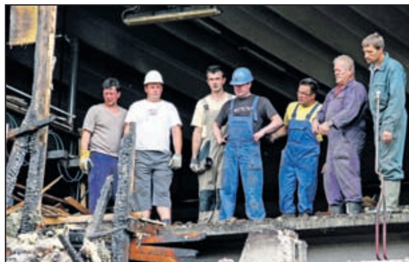
Mukotrpno, obsežno odstranjevanje posledic požara (foto: Jože Miklavc)
