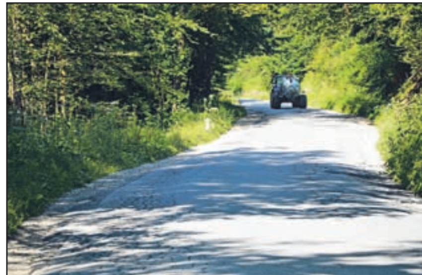
Državna cesta Velenje–Polzela je najbolj uničena skozi sotesko, ki vodi do Ložnice. Krajanji so jezni in obupani, saj že vrsto let poslušajo obljube, da bodo cesto obnovili.
