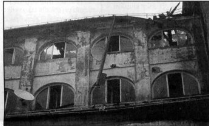
Najbolj nujno je zaščititi objekt pred nadaljnjim propadanjem.
