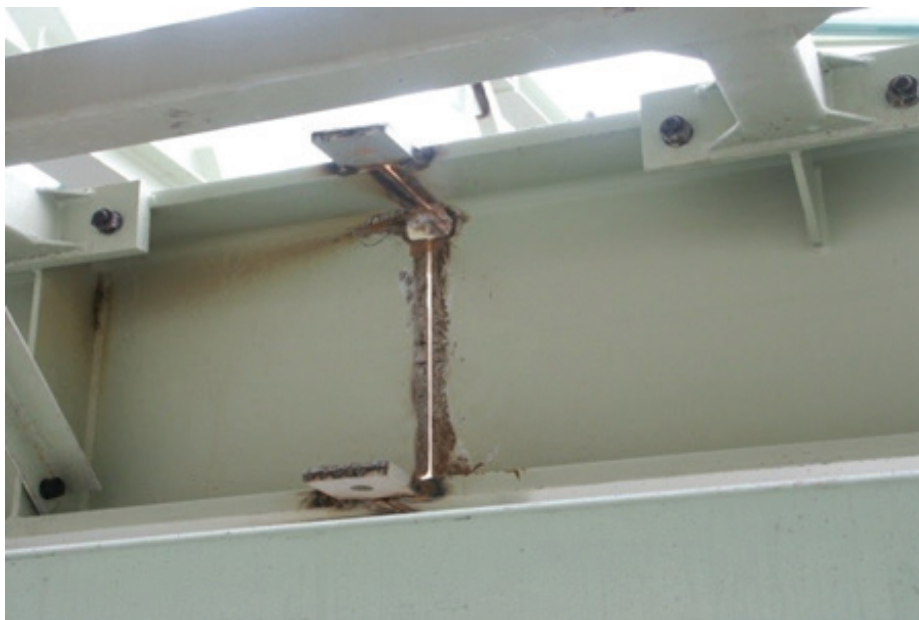
Slika 2 • Nepotrebno varjenje pri montaži.
