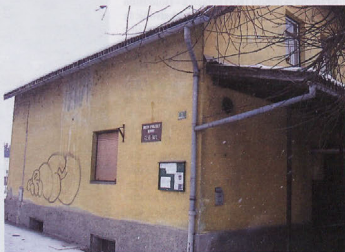
Stavba, v kateri imajo prostore medvoški upokojenci, je potrebna obnove. / Foto: Maja Bertonec
