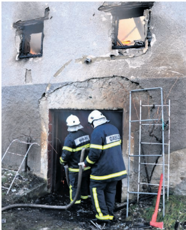
Foto: PGD Poljčane »Do požara v dimniku pride zaradi vžiga gorljivih snovi v dimniku. Vzrok za to so skoraj vedno slabo vzdrževanje, dotrajanost dimnika, slaba vleka ali celo napačna gradnja dimnika,« je povedal Dragomir Murko z Uprave RS za zaščito in reševanje. Dimniškega požara se nikoli ne sme gasiti z vodo. (Fotografija je simbolična.)
