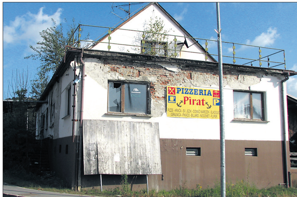
Foto: SM Podirajoči se bivši gostinski objekt Pirat bo zaenkrat še stal; lastnik se je namreč pritožil na potek druge dražbe, na kateri je občina objekt odkupila za ureditev parkirišč in manjšega parka.
