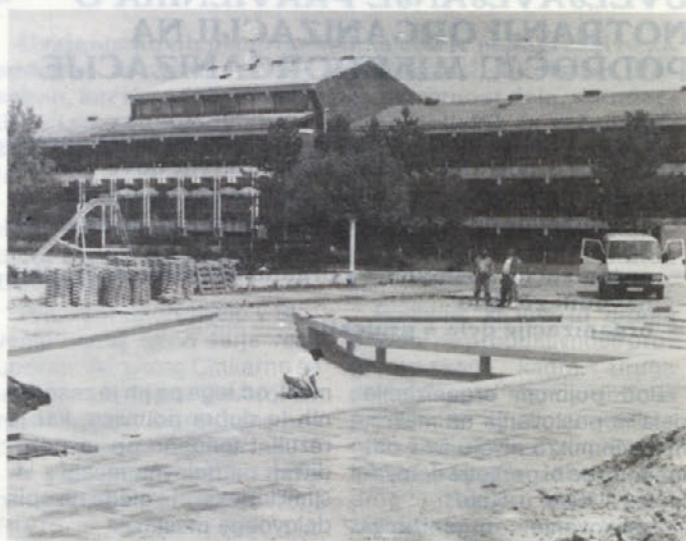
Celjski odprti bazen smo letos še pred sezono kopanja sanirali z Nivedurjem in Epoktitom.
