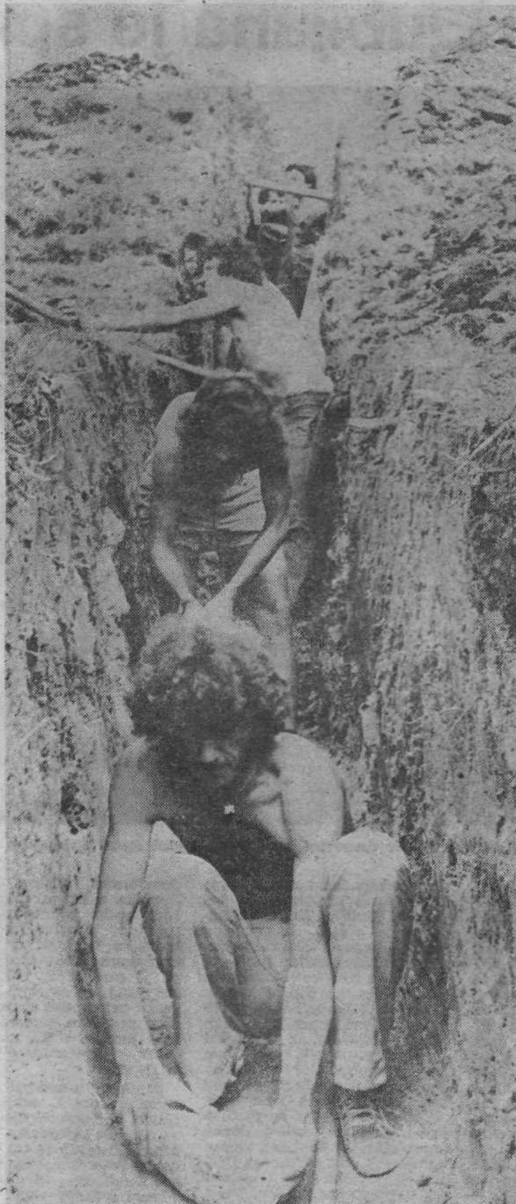
Treba je poseći kar globoko v zemljo, da bo vodovod pravilno zgrajen.
