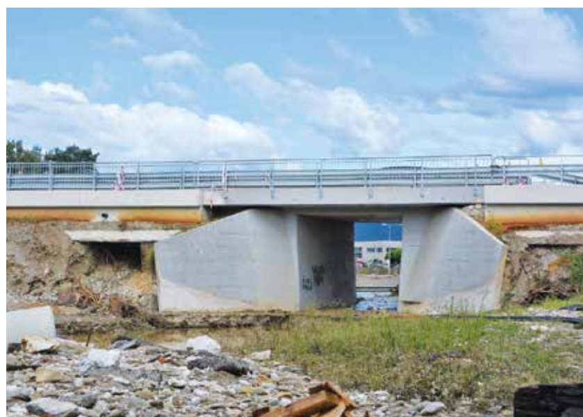
Na Grobeljskem mostu v Latkovi vasi so poškodbe, ki jih je naredila deroča Savinja, že sanirali.
