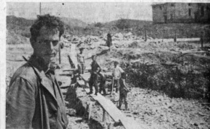
Vegradov delovodja FRANC REDNAK, je povedal, da bodo do roka zgradili novo šolo v Sentilju
