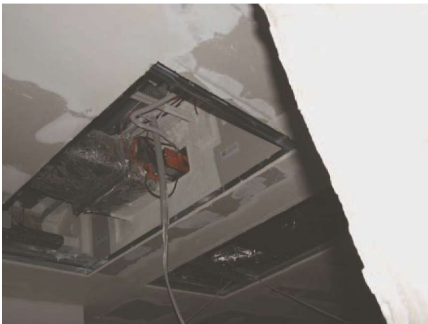
Vgrajena požarna loputa v meji požarnega sektorja nad spuščanim stropom
