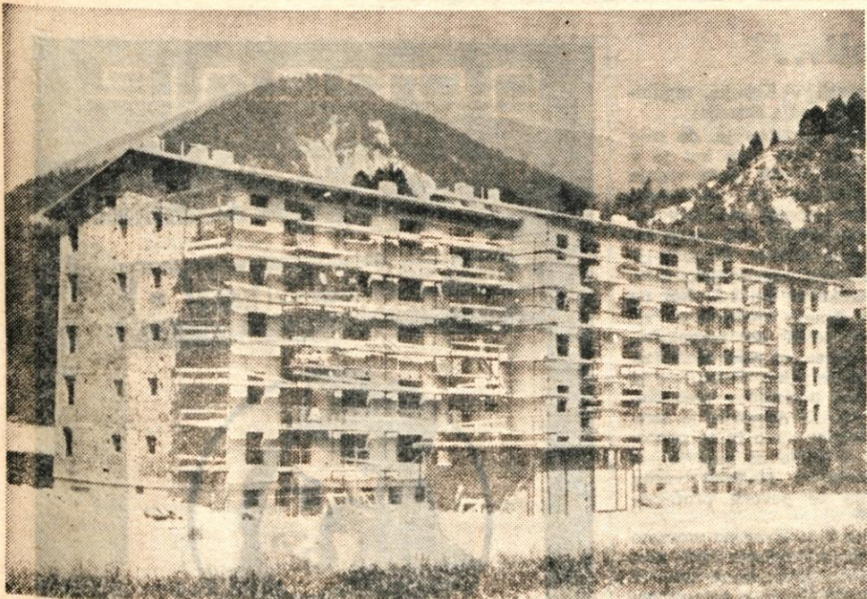
V Bistrici pri Trziču gradi kranjski Projekt 60 stanovanj za trg. Po načrtih bodo stanovanja vseljiva že letos septembra. V kratkem pa bo omenjeno gradbeno podjetje začelo graditi v soseski B-4 v Bistrici še drug stanovanjski blok s 60 stanovanji, ki bodo vseljiva prihodnjo jesen. (vig) Foto: F. Perdan
