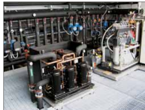
Toplotna črpalka in razvod geosond
