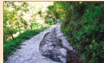
Poškodovana cesta v Obrštab, KS Zlato Polje
