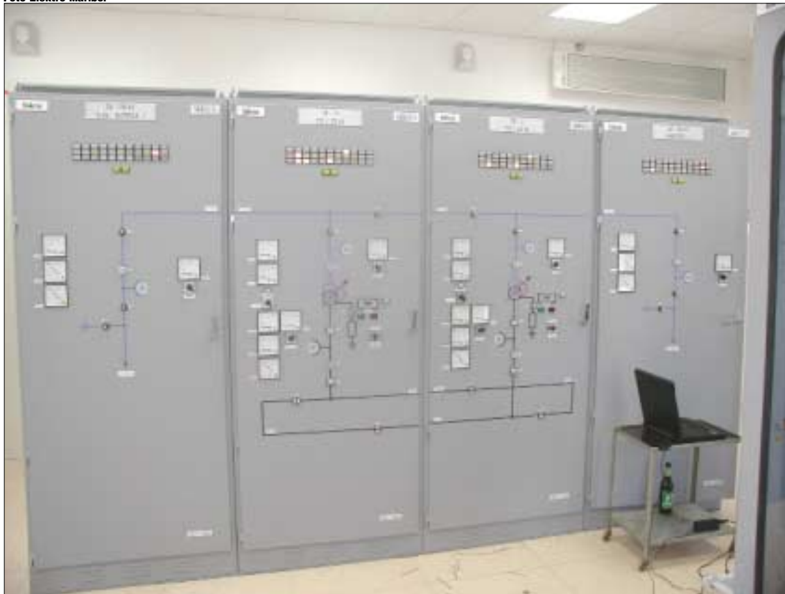
RTP 110/20 kV Rače.
