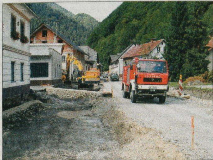
Skozi stari del Železnikov, Na Trnju, poteka najbolj zahtevna rekonstrukcija regionalne ceste.
