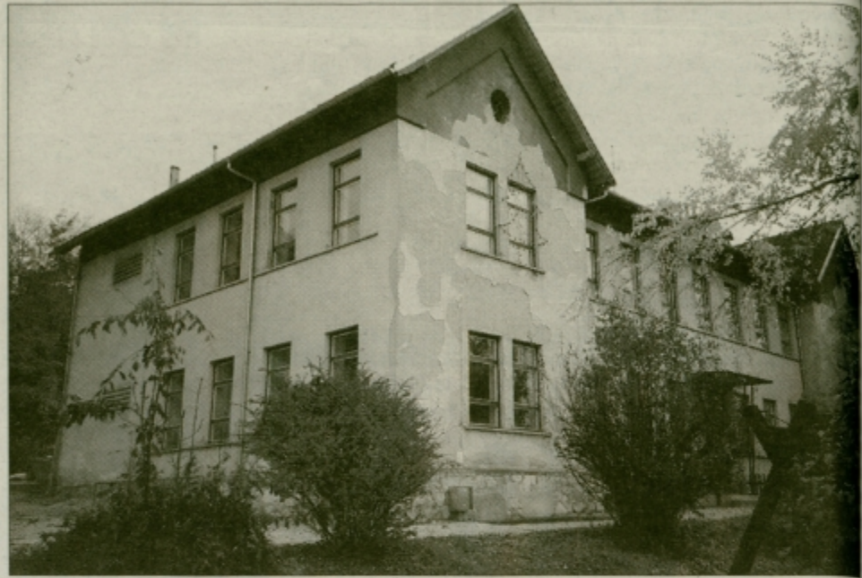
S pročelja III. Osnovne šole Rogaska Slatina, namenjene otrokom s posebnimi potrebami iz šestih obsoveljskih občin, odpadajo veliki kosi fasade.
