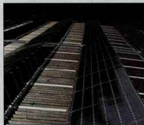
Vsa streha velikega servisnega objekta HE Medvode je pokrita s fotovoltaičnimi elementi (sončnimi celicami) male sončne elektrarne.
