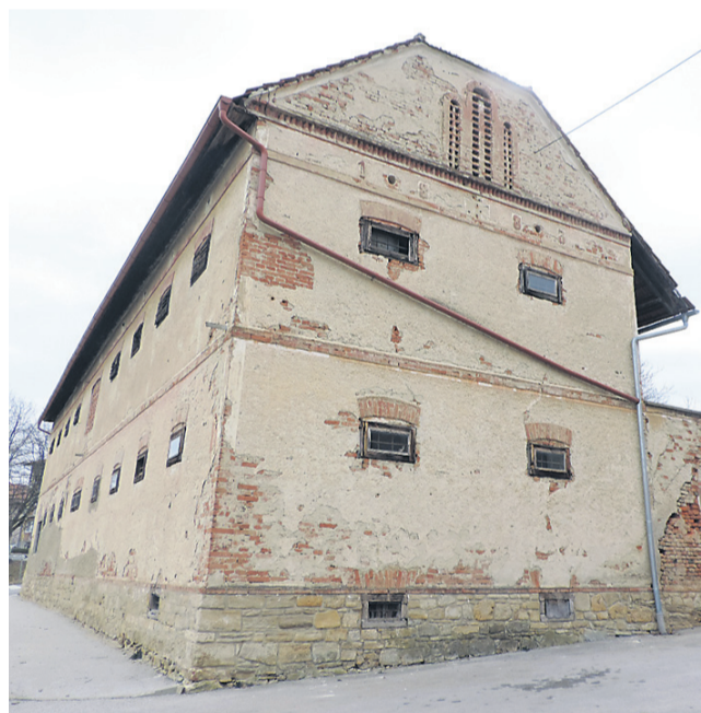
Zapuščeni objekt, znan pod imenom Farovške štale, stoji tik ob glavni cesti, v bližnji okolici šole in vrtca.
