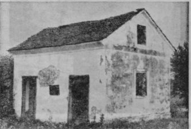
Da je pokopališče res zanemarjeno, priča tudi mrtvašnica, ki je v nemogočem stanju
