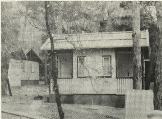
Na vseh strehah bo zamenjana strešna lepenka in položeno 1800 novih salonitnih plošč.
