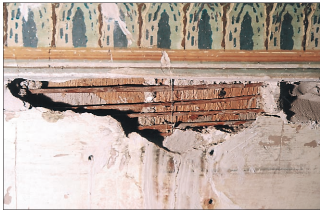
Poškodbe so bile zelo velike. Tukaj se lepo vidi način gradnje ormoškega gradu: stene so iz desk, ki so jih prepletli s trstiko in ometali.
