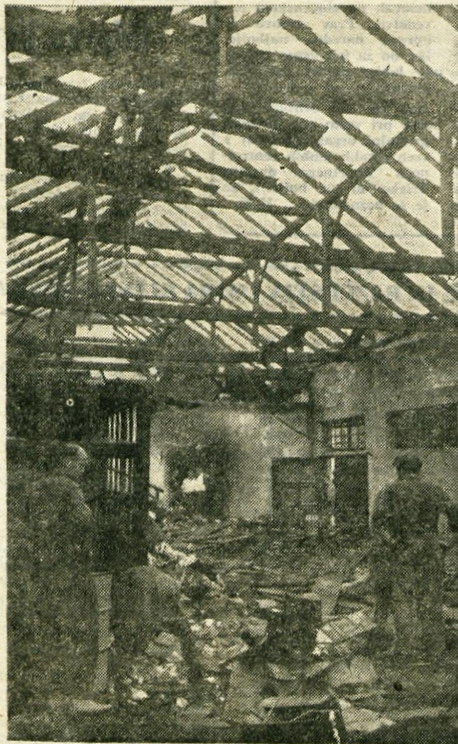
V ponedeljek dopoldan je pogorelo veliko skladišče trgovskega podjetja »Živila« Kranj. Materialna škoda znaša že po prvi ocenitvi okoli 40 milijonov dinarjev. Preiskava o vzroku požara je v teku.
