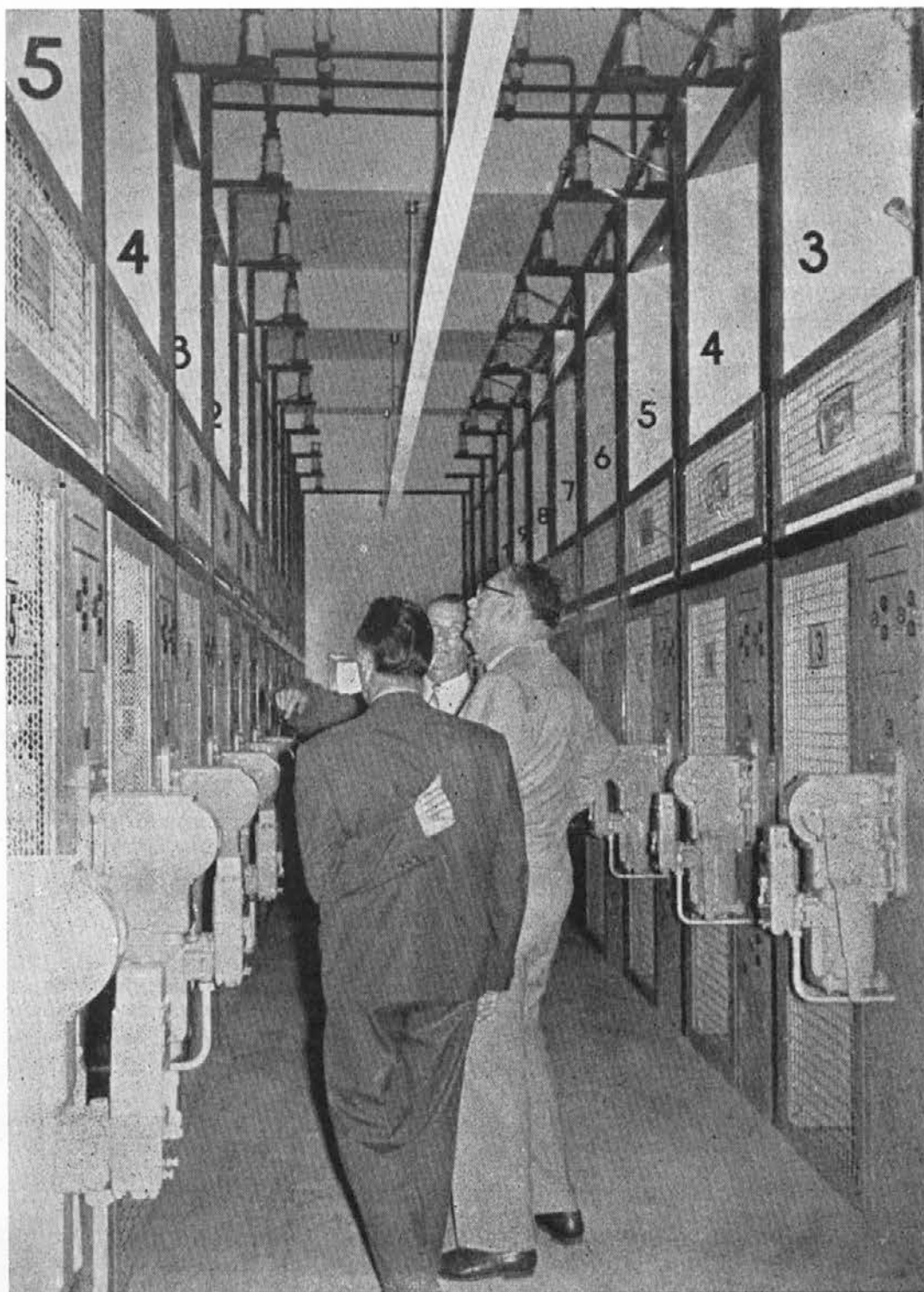
Podpredsednik Franc Leskošek-Luka si je oglelal tudi paralelno transformatorsko postajo za novi agregat, ki je naša najmodernejša izvršitev
