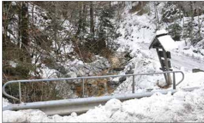
Pred sanacijo je hudournik ob neurjih z erodiranim materialom mašil prepust pod državno cesto Luče-Solčava.
