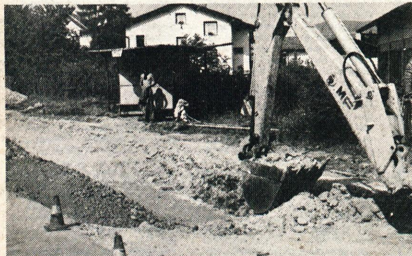
»Nedorečeno«! Tako bi lahko rekli za opravljena dela in asfaltiranje avtobusne postaje na zvezni cesti. Površina je asfaltirana, kovinski nadstrešek, kini v okras, pa je ostal.
