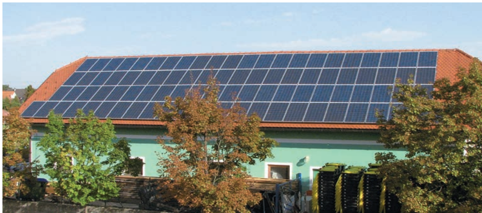
Komunalno podjetje je na streho z ugodno južno lego namestilo 90 modulov, ki je doslej proizvedlo že 61.845 kWh električne energije
