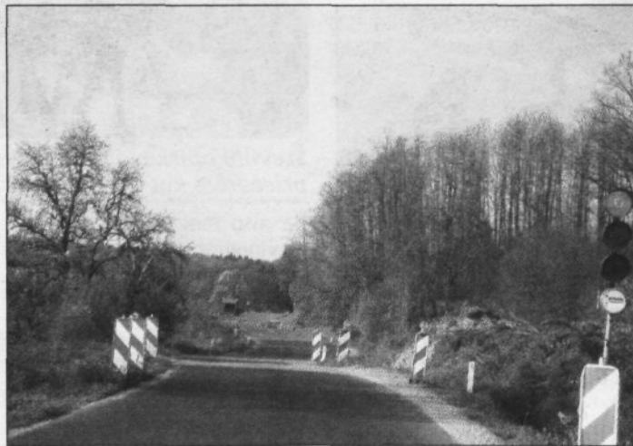
Na območju plazu Istenič je vzpostavljena polovična zapora ceste, promet je usmerjen s semaforjem.
