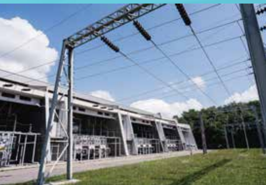
Foto 1: Regulirno-usmerniški transformatorji za elektrolizo
