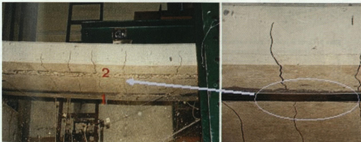
Slika 7: Začetek porušitve utrjene plošče z odlepljanjem ogljikovih trakov
