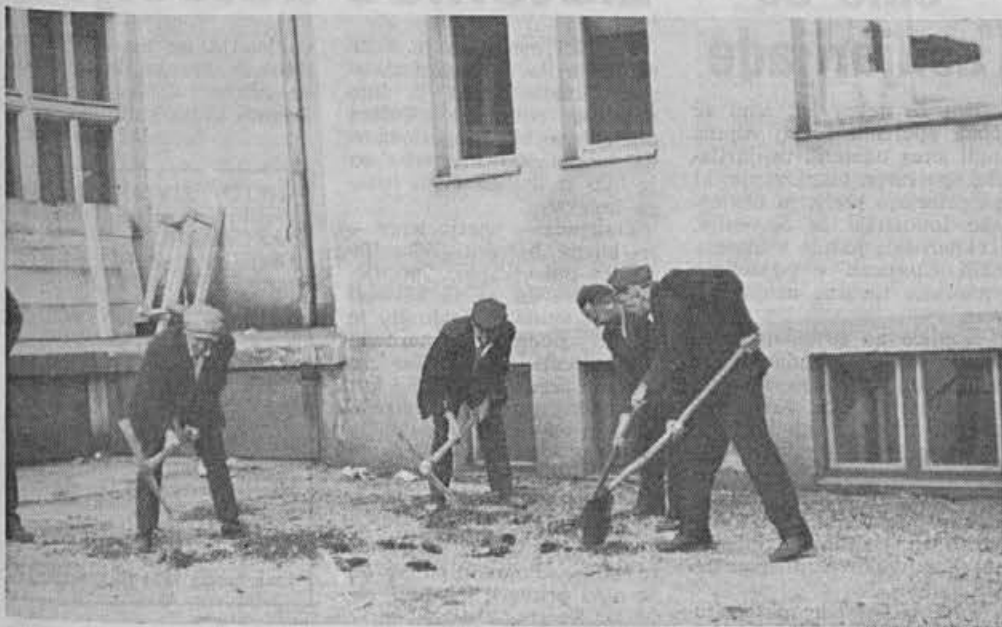
Tehnična ekipa išče »prekinjeni kabel«
