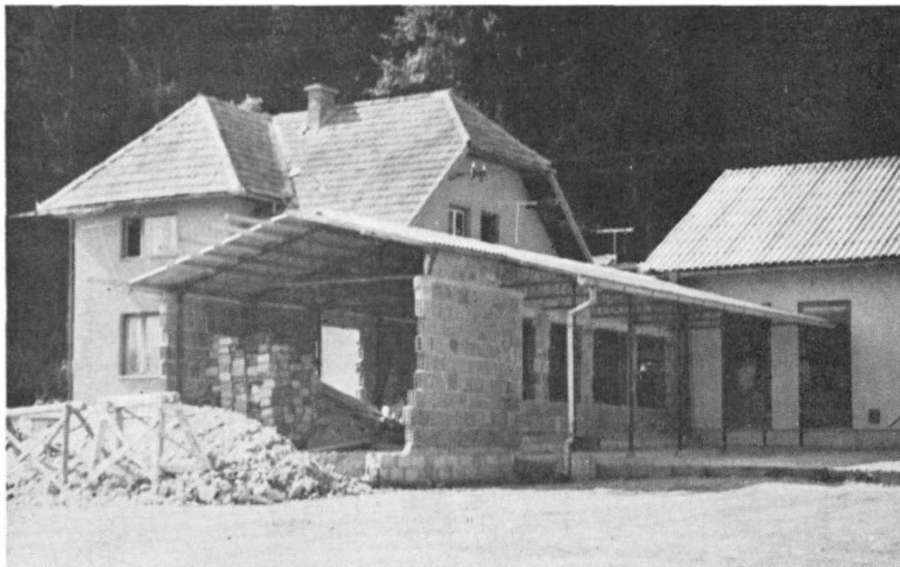
Na naši sliki je primer iz Pesja, ko je graditelj moral porušiti del objekta, ker ni gradil v skladu z lokacijsko dokumentacijo
