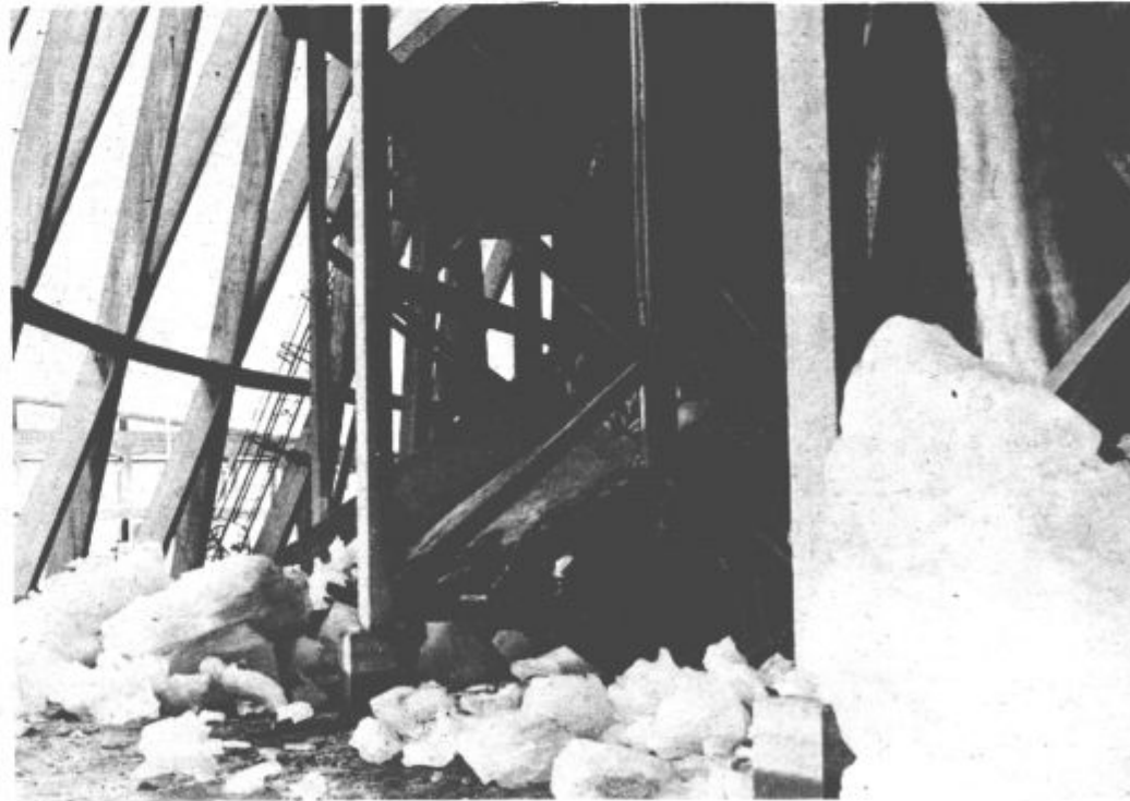
Zaradi porušitve dela pršišča hladilnega stolpa 345 MW so v šoštanjkih Termoelektrarnah proizvedli 8 milijonov kWh električne energije manj, kot bi jo sicer.
