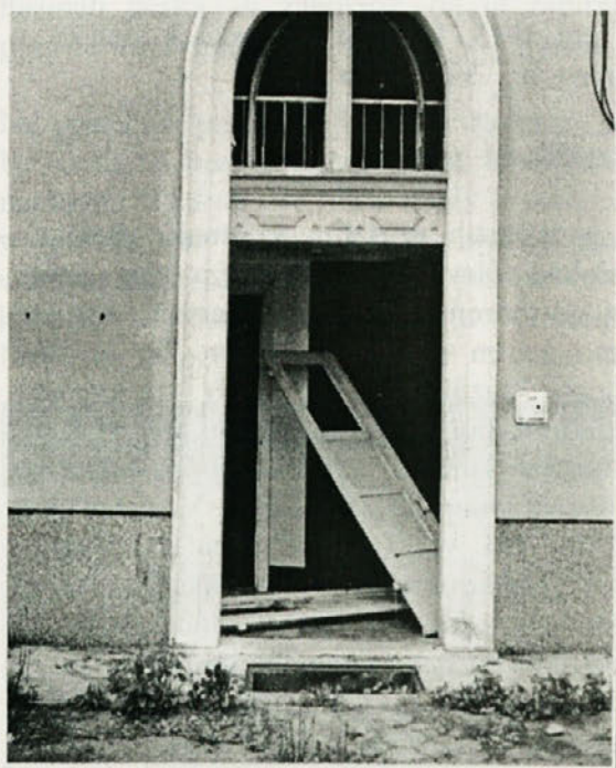
Največji, polkrožni portal v Vipavi, ki sega še v prvo nadstropje poslopja v nekdanji avstrijski južni vojašnici - danes slika nekega razpada.
